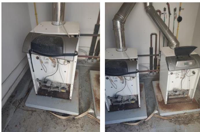
Figura 21: Calderas de ACS spa
