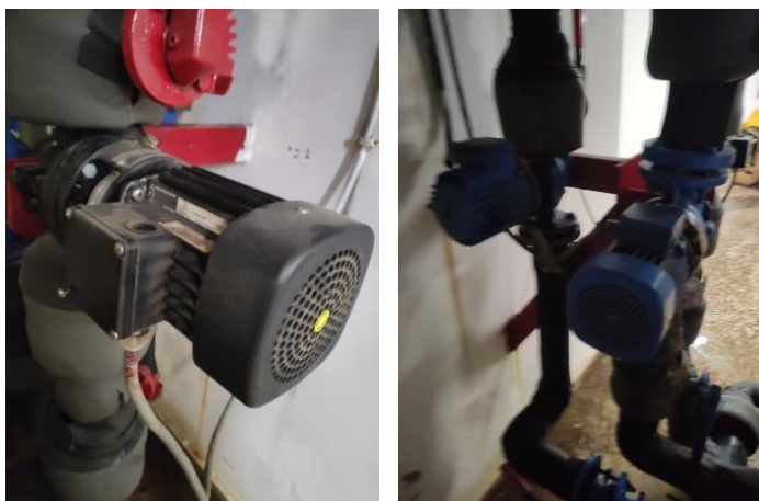
Figura 20: Bombas de impulsión ACS
