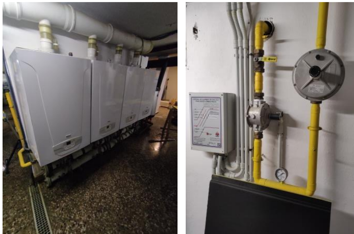
Figura 19: Calderas de ACS
