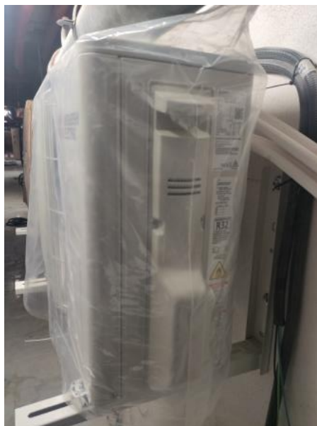
Figura 15: Equipos autónomos todavía no puesto en servicio
