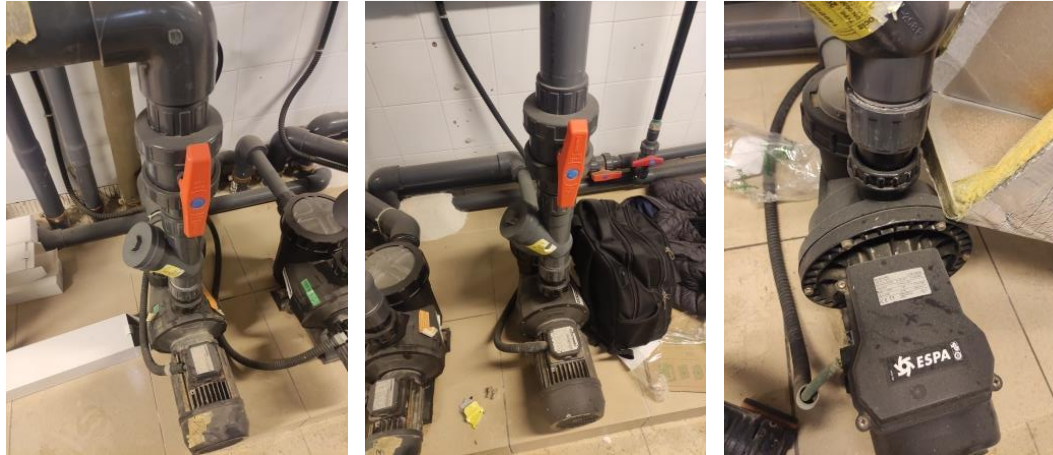
Figura 22: Bombas de impulsión ACS spa
